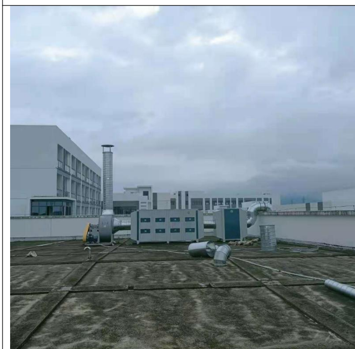
浸漆废气处理设施
