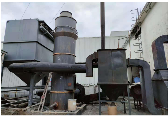
锅炉废气处理
