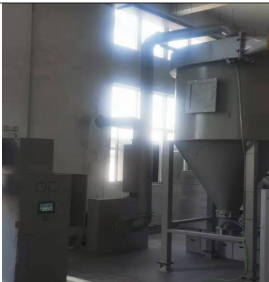
废气粉尘处理前管道
