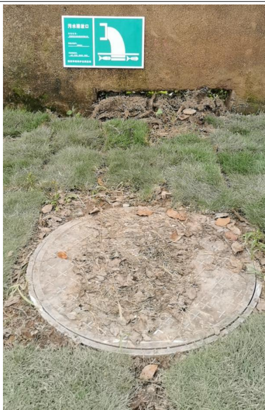
污水总排口标识牌
