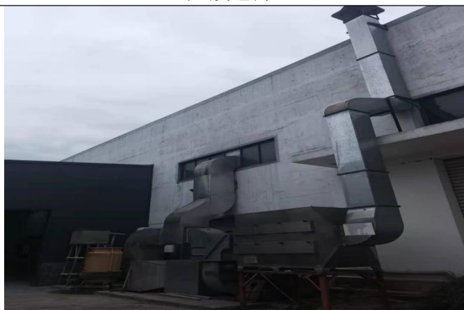
PET 离型膜涂布工序废气处理设施
