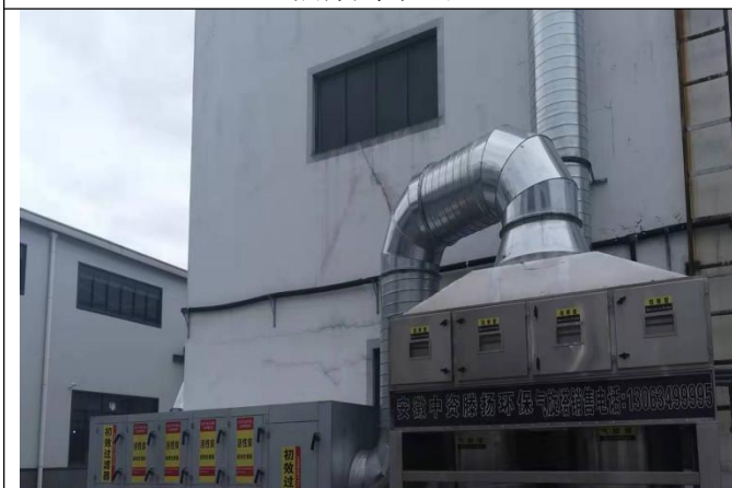
淋膜、涂布、印刷工段废气处理设施
