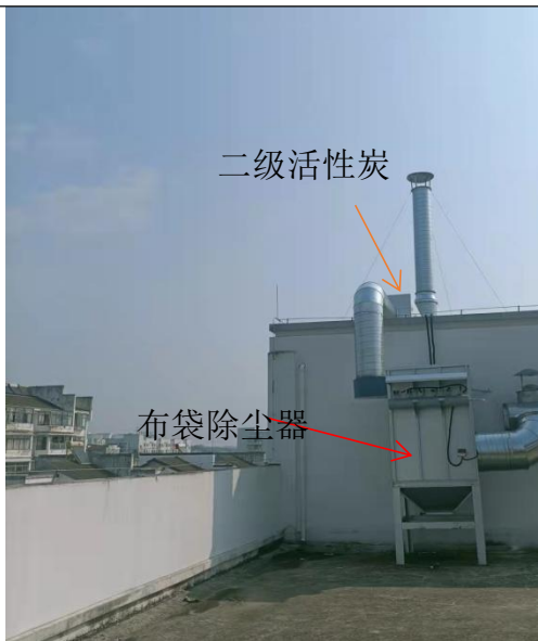
废气处理设施
