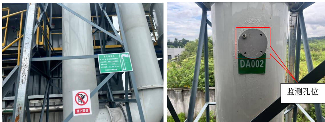
图 4.6-1 厂区 DA002 废气排放口标识牌及采样孔照片
