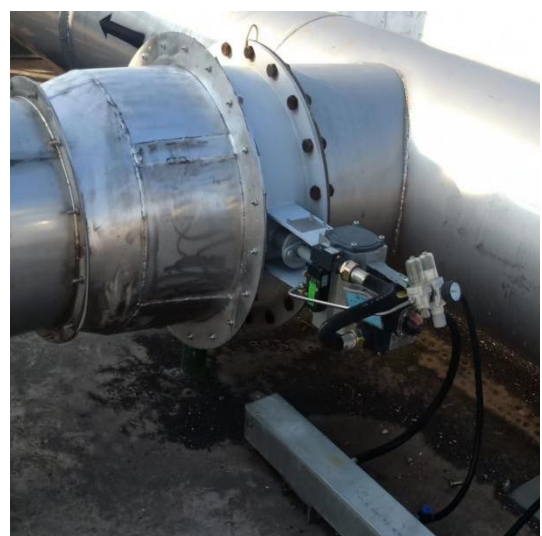
切断阀（备用废气处理设施）
