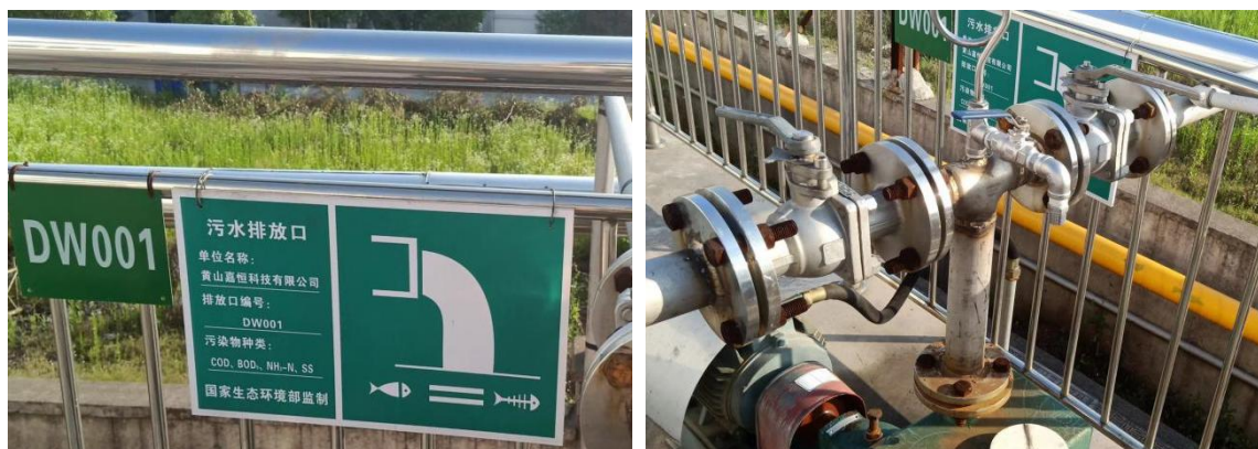
图 4.6-4 厂区 DW001 废水排放口标识牌照片
