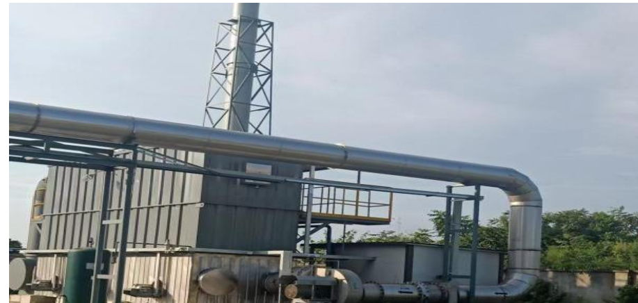
废气处理设施
