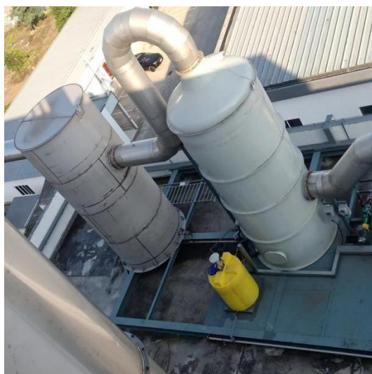
一级碱喷淋塔
