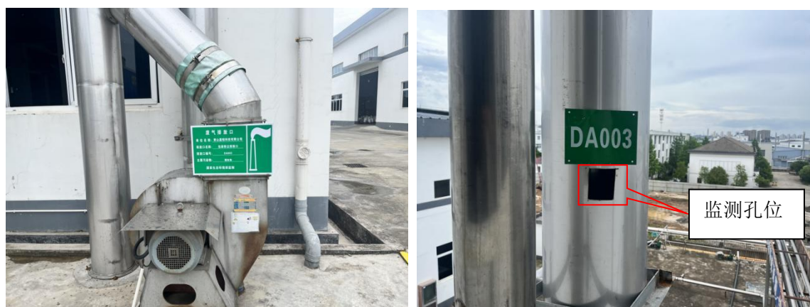
图 4.6-2 厂区 DA003 废气排放口标识牌及采样孔照片
