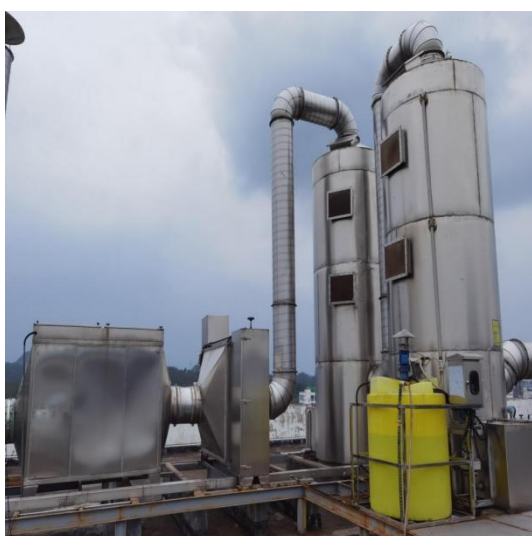
碱喷淋+水喷淋+光催化裂解（备用）
