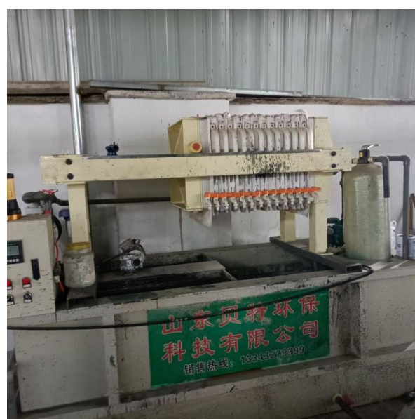
废水处理设施
