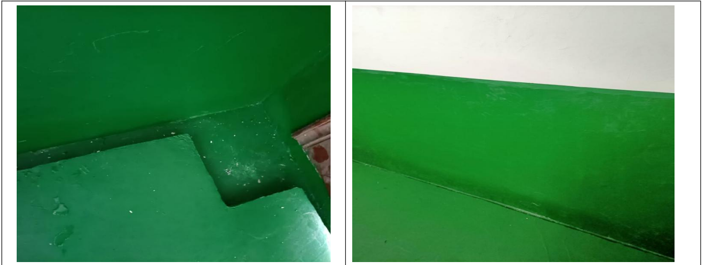
危废间导流沟及集液槽
