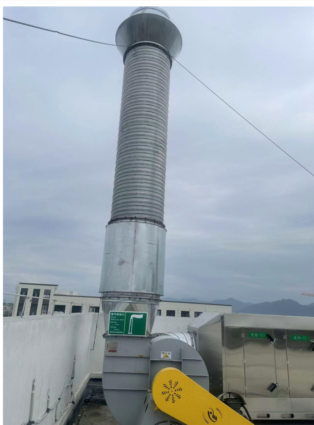
DA002 活性炭吸附装置排气筒
