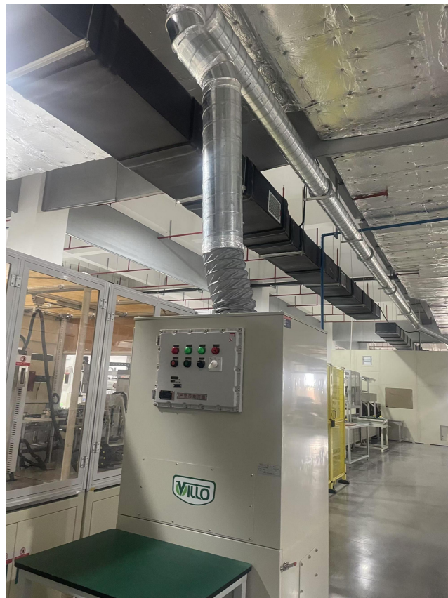
滤筒除尘器废气出口
