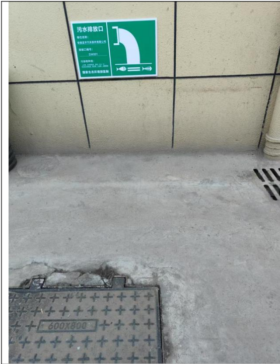
污水排放口标识牌
