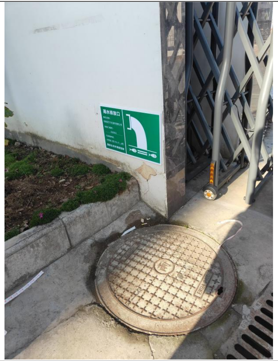
雨水排放口标识牌
