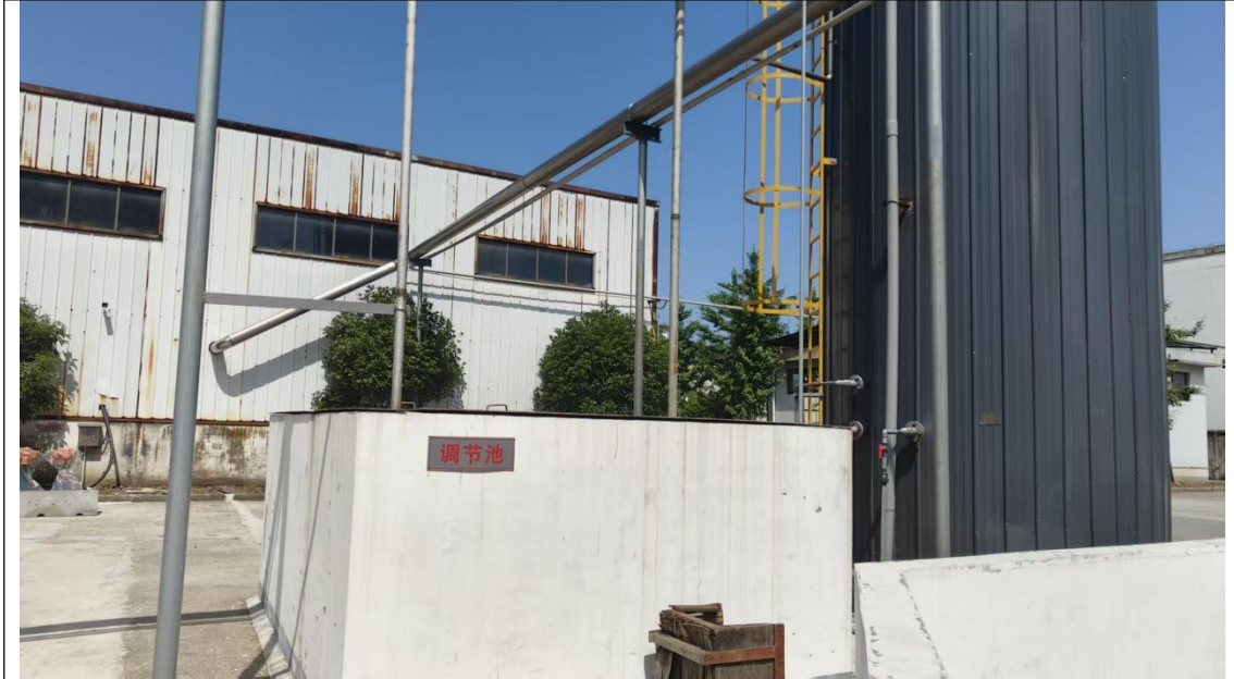
调节池+UASB 装置
