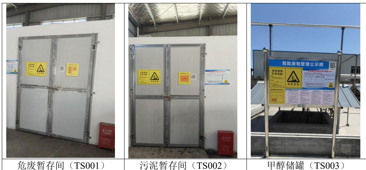
图 4.2-6 危废贮存场所照片
