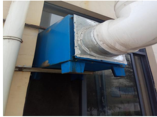
油烟净化装置（老厂区）
