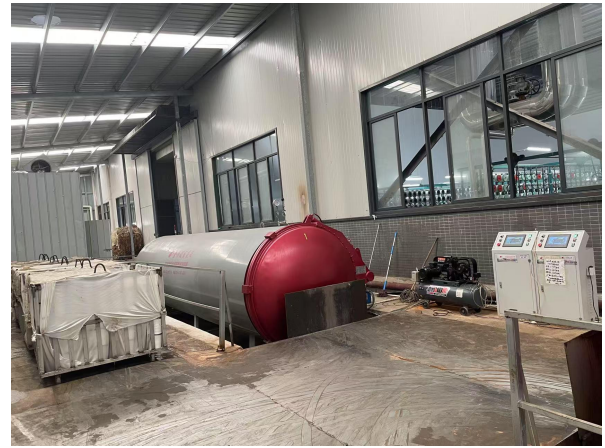
新增蒸箱（联枫厂区）
