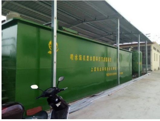
1#厂房配套废水循环回用系统（老厂区）
