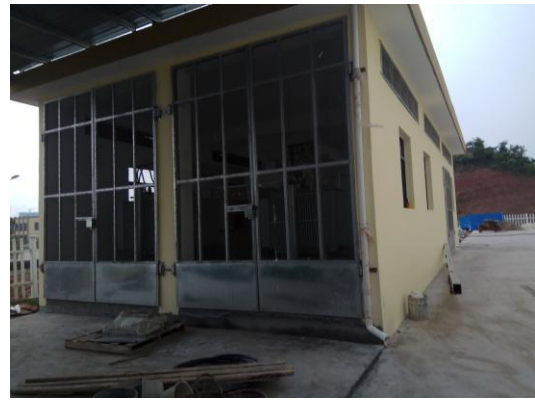
配电房（老厂区）
