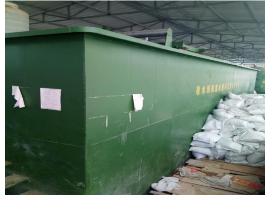
2#厂房配套废水循环回用系统（老厂区）
