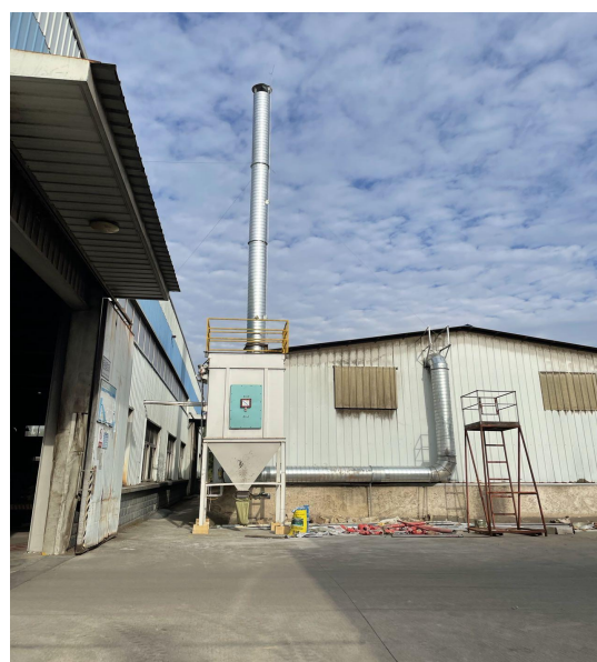
DA005 破碎废气治理设施及排气筒
