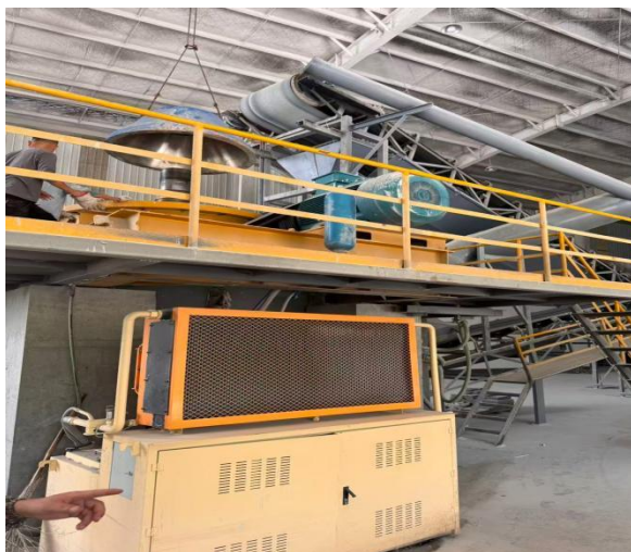
废气收集设施
