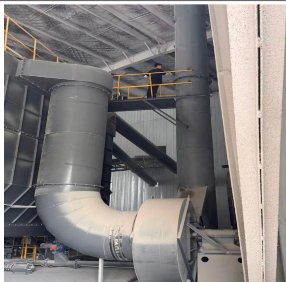
废气处理设施
